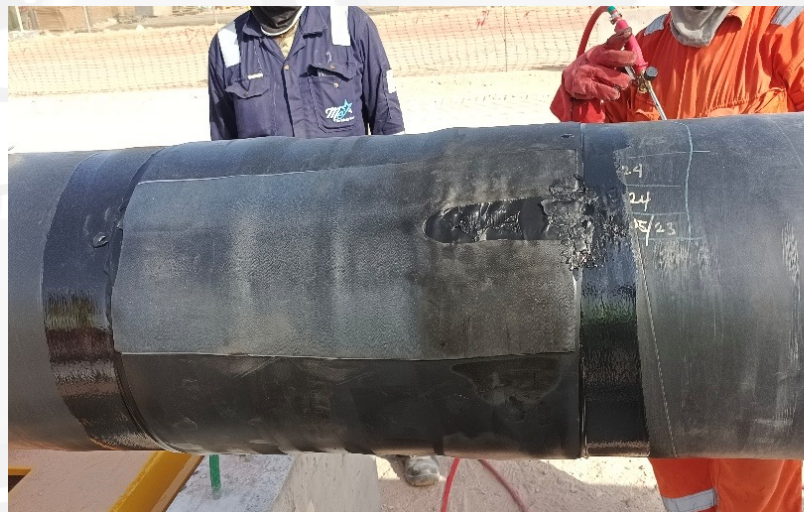
Pęknięcie zaklejki w wyniku przegrzania
