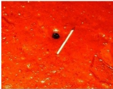
Przykład korozji miejscowej
