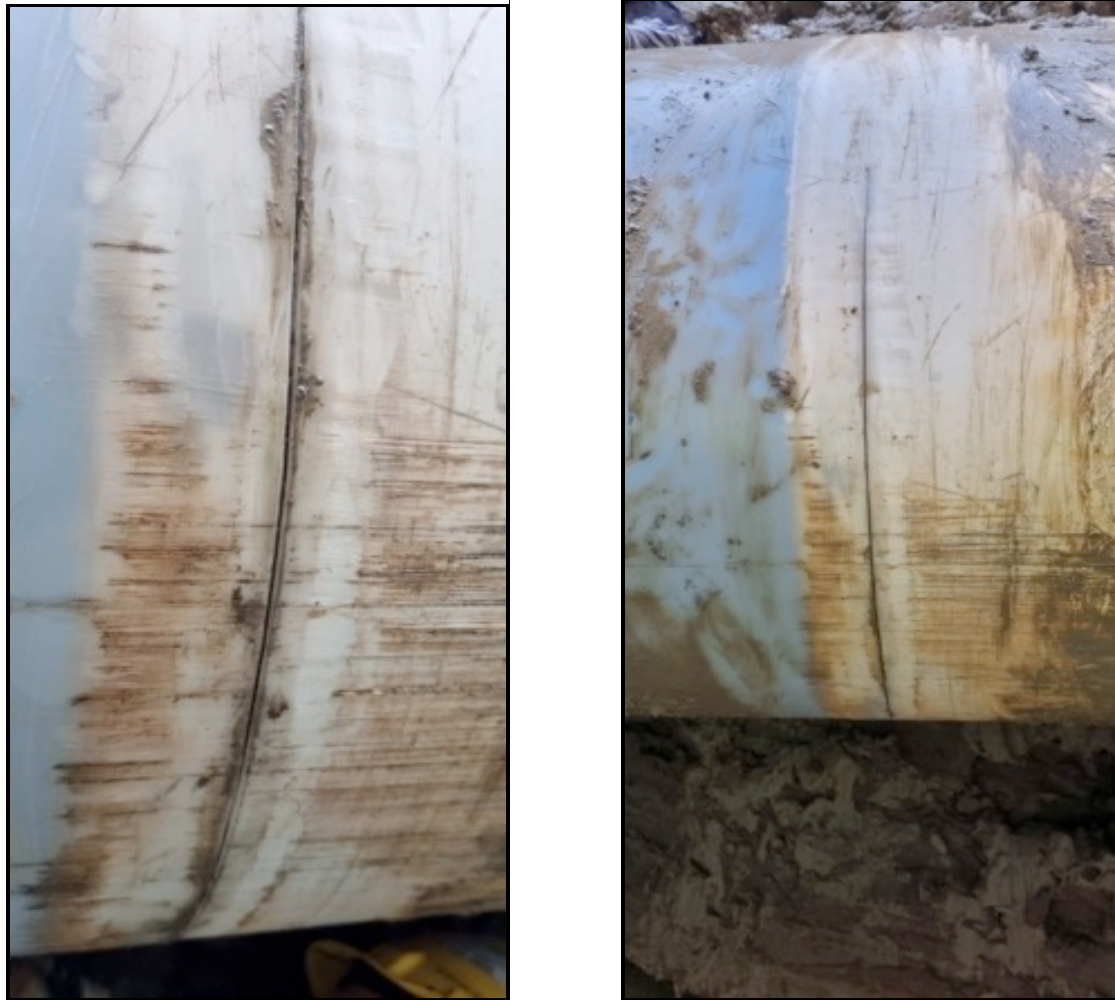
Rys. 6. Widok defektu izolacji po odkryciu gazociągu DN700
